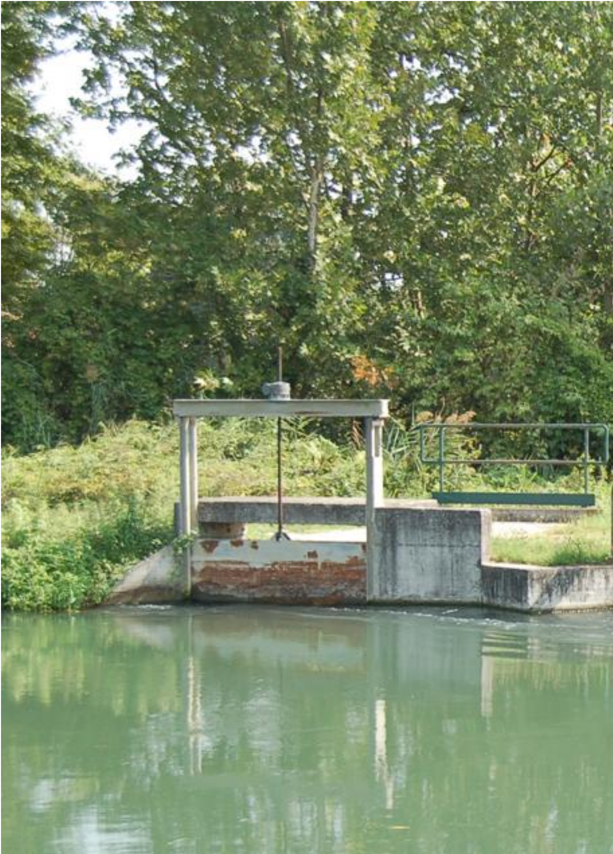
Bocca di presa del cavo Almos.
